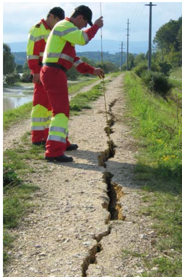
Danni a un muro di protezione contro le piene lungo il canale dell'Hagneck, nel Seeland bernese. Un'approfondita analisi degli eventi ha rilevato la necessità di sottoporre l'opera a un risanamento totale. I lavori sono stati avviati alla fine del 2010.
