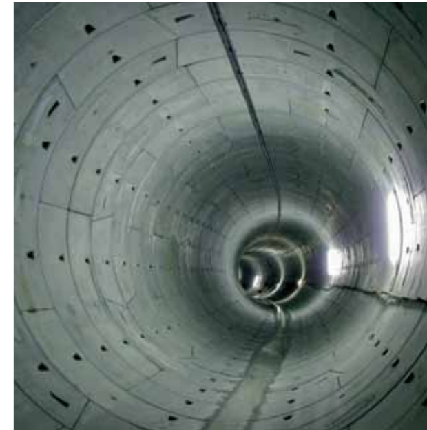
Cette galerie achemine une partie des eaux de l'Aar lorsque le niveau du lac de Thoun monte rapidement.
