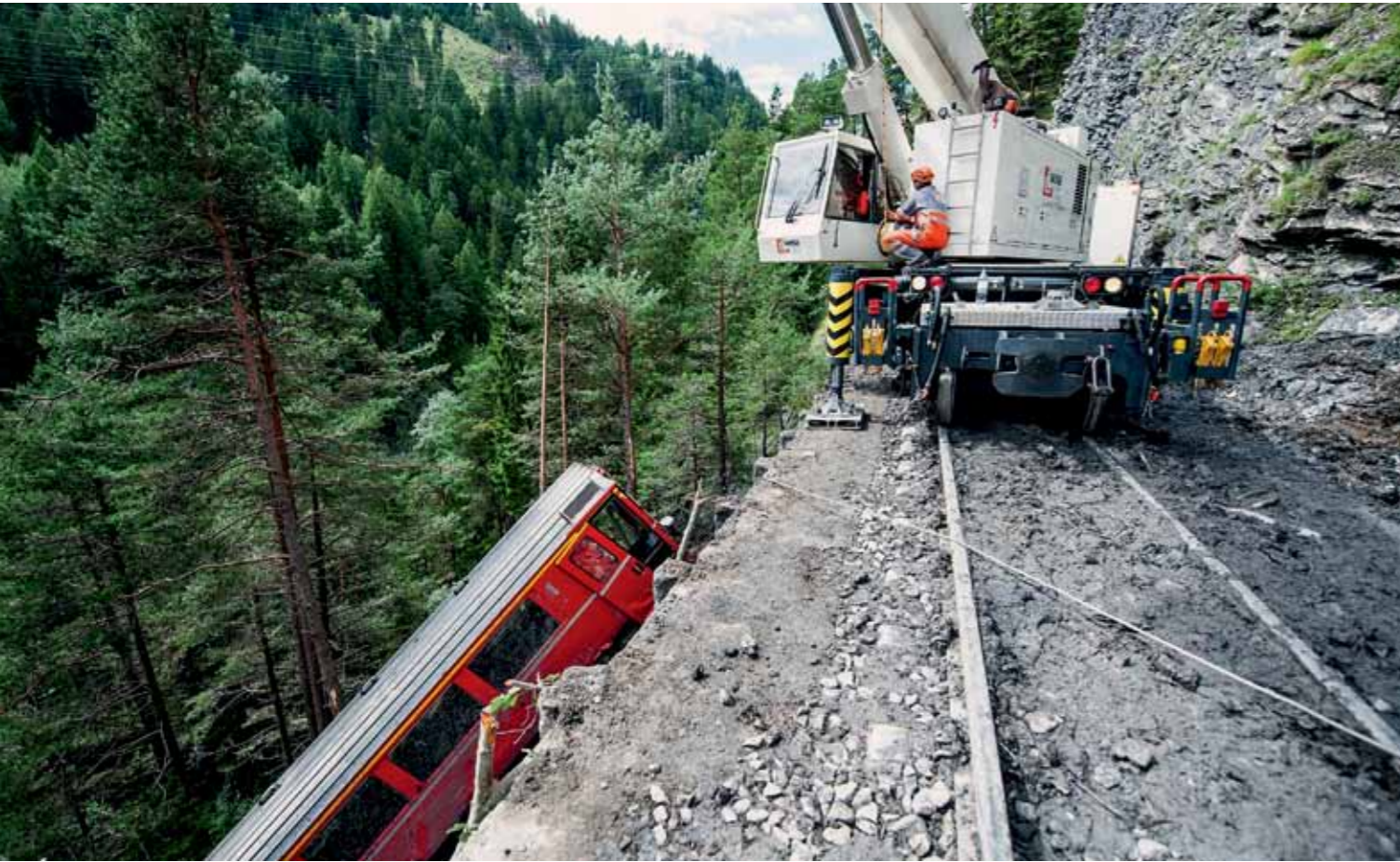
Opération de sauvetage efficace après l'accident d'un train de voyageurs qui a heurté un glissement de terrain dans une pente raide près de Tiefencastel (GR).
