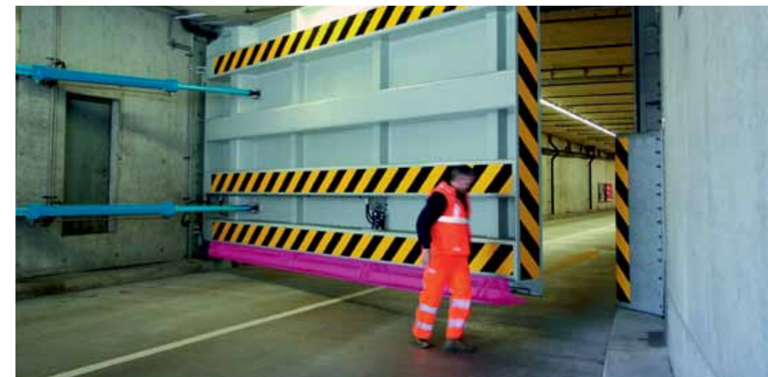
Nouvelle paroi anticrue destinée à protéger un parking souterrain au cœur de la ville de Zurich.
