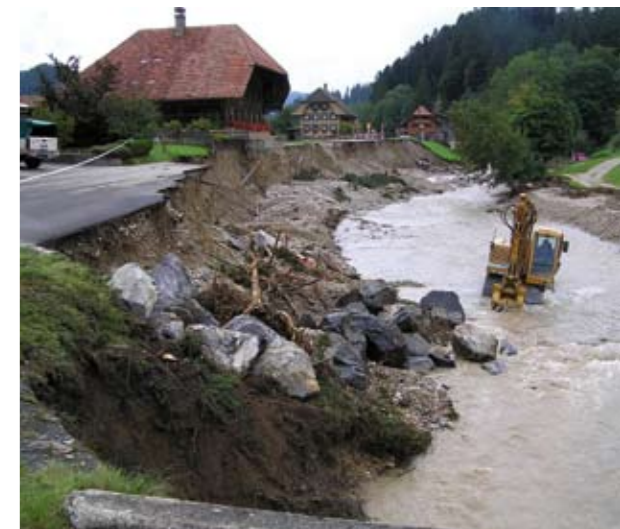
Gravierende Ufererosion der Trub BE im Emmental durch das Hochwasser vom August 2005.
