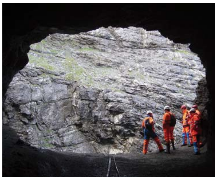
La construction d'une galerie d'écoulement a permis d'atténuer le danger en vidangeant sous contrôle les eaux de fonte accumulées dans le lac glaciaire situé au front du glacier inférieur de Grindelwald.
