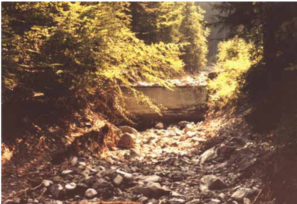
Abb. 3.9: Gerade Wildbachsperre aus (Stahl?) Beton. Nicht nach den Regeln des Vollverbaus angeordnet. Nach einem Hochwasserabfluss hat sich die Gerinnesohle vor der Sperre auf das Grenzgefälle (wenige Prozent) abgesenkt. Dadurch wurde das Sperrenfundament freigelegt.
