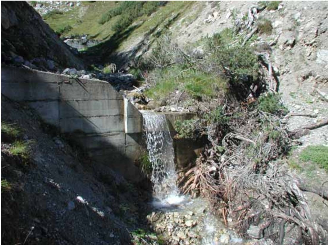
Abb. 3.10: Durch seitliche Einrutschung teilweise verkleaste Abflusssektion (E. Frick, tur gmbh).
