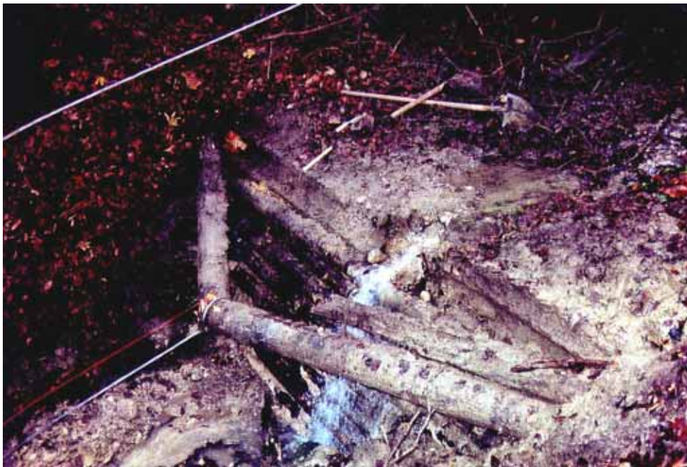
Abb. 3.7: 60-jährige Rundholzsperrre bei Hirzel ZH. Die Sperrentreppe musste erneuert werden und einzelne Sperren wurden bezüglich der Holzfestigkeit untersucht (Noetzli et al., 2002). Die Rundholzlagen sind seitlich in die Flanken eingebunden und tragen somit von Flanke zu Flanke. Sofern die Flanken abrutschen, kollabiert eine solche Sperre. Das gleiche gilt sinngemäss auch für Stahlbetonsperren, welche als Balken oder Platten von Flanke zu Flanke tragen.
