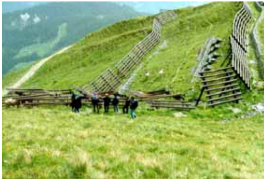
Abb. 4.1: Lawine zerstörte zahlreiche Stützwerke (Gefährdungsbild 2). Die Lawine ist oberhalb der Verbauung angebrochen.
