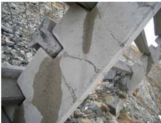
Abb. 4.4: VOBAG-Stützwerke mit Rissbildung im Träger. Mittelfristig ist die Tragfähigkeit nicht mehr gewährleistet.
