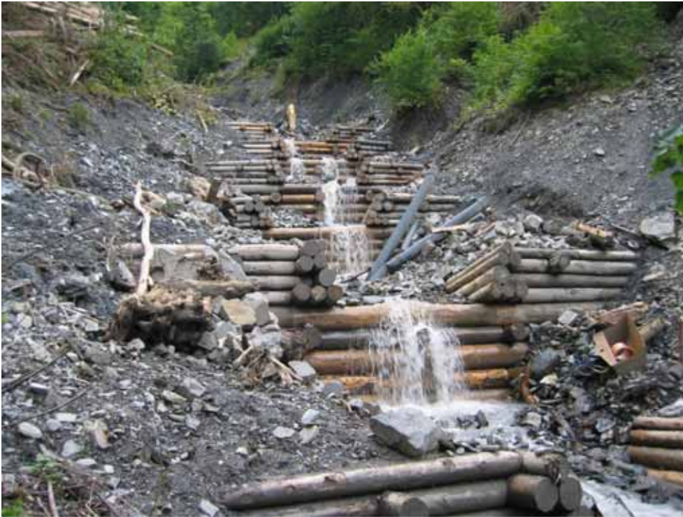
Abb. 5.2: Sperrentreppe im Wilerlibach 2005 unmittelbar nach den August-Unwetterereignissen (Aufnahme H. Duss). Starke Geschiebeablagerungen; insbesondere steile Hinterfüllung der Sperrenflügel. Die Erosionserscheinungen an den Ufern waren grösstenteils bereits vor dem Unwetter dokumentiert. Rechts im Bild ist die Schaufel des beim Unwetter zerstörten Schreitbaggers zu erkennen. Die beiden im Gerinne liegenden Kunststoffrohre stammen aus der Wasserhaltung, welche vor und während der Bauarbeiten in Betrieb war.
